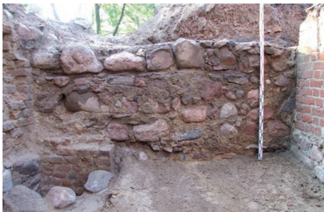
Ryc. 18. Kruszwica, stan. 2. Zachowane pozostałości „kominka” oraz południowego lica muru obwodowego w piwnicy 2, „kamienicy” zamkowej. Fot. P. Pawlak
